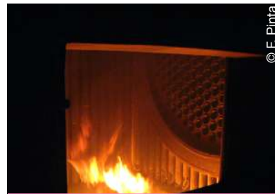
Foyer d'une chaudière à bois pour la production de vapeur alimentant une turbine (Brésil)
